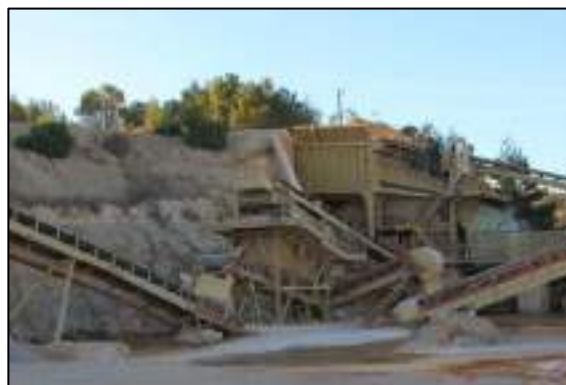
Concasseur à percussion (BP1) + crible (C1)
